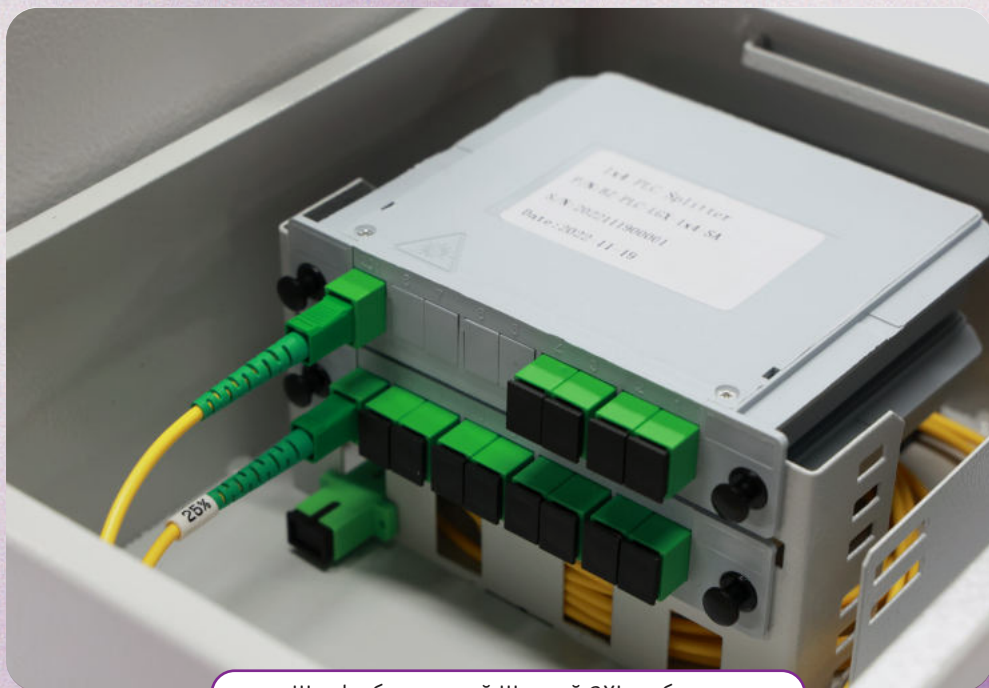
Шкаф абонентский Шарпей-3XL в сборке
