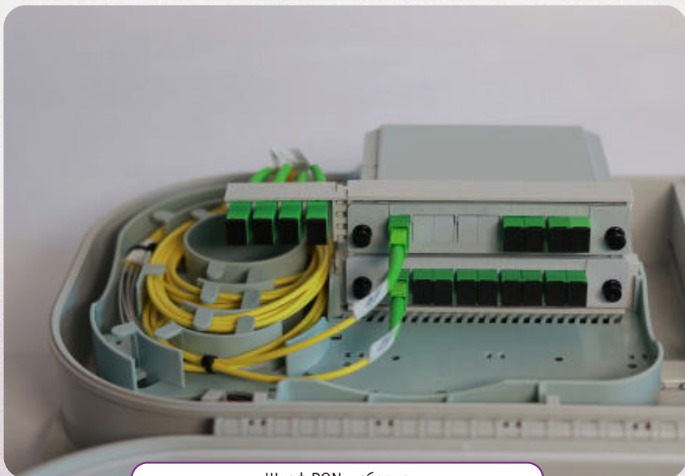
Шкаф PON в сборке
