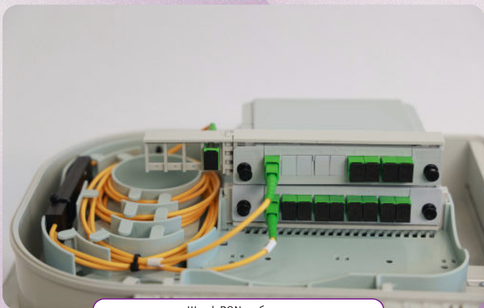
Шкаф PON в сборке
