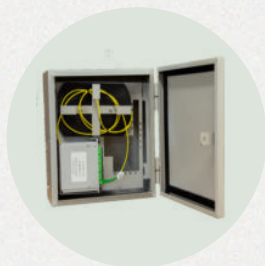
Шкаф со сварками Елец-2
